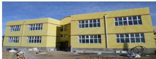
“Говийн оюу хөгжлийг дэмжих сан”-ийн санхүүжилтээр баригдаж буй Даланзадгад сумын 26 дугаар цэцэрлэг, Гүйцэтгэгч Жи-Жи-Ай ХХК
